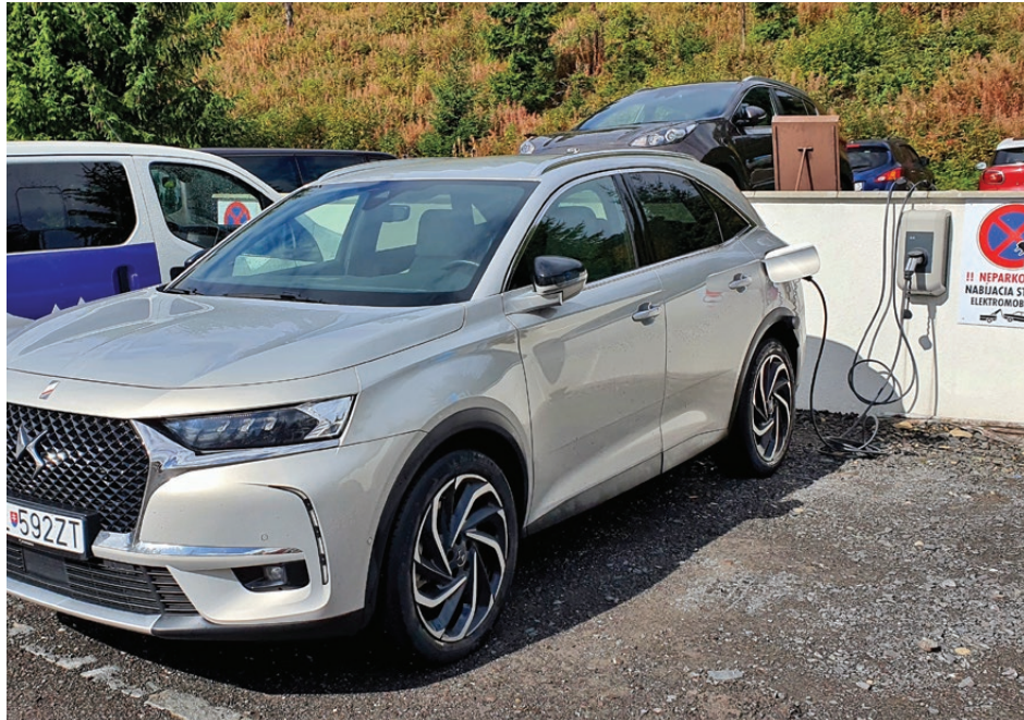
■ S AC nabíjaním sa okrem domáceho wallboxu stretnete aj v obchodných centrách, na verejných priestranstvách alebo pri hoteloch a reštauráciách
